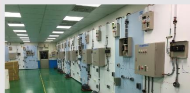
B103室內配線實驗室
