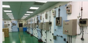
B103室內配線實驗室
